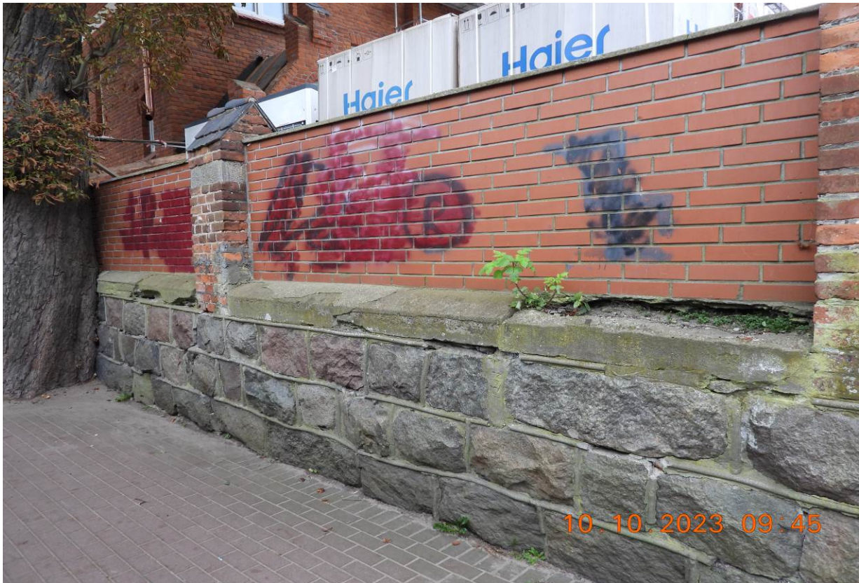
Zdjęcie nr 22. Widok zamurowanej części ogrodzenia od strony alei Kościuszki. Przęsa stalowe do odtworzenia. Źródło: Zdjęcie własne.
