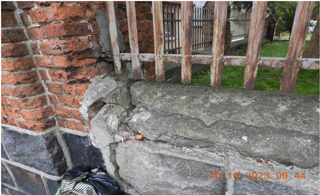
Zdjęcie nr 16. Widok uszkodzeń muru oporowego i betonowego zwieńczenia. Źródło: Zdjęcie własne.
