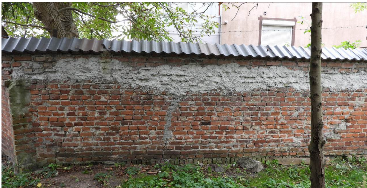
Zdjęcie nr 27. Ogrodzenie ceglane, wewnętrzne szpitala. Część wtórnego, przemurowanego muru ceglanego. Źródło: Zdjęcie własne.
