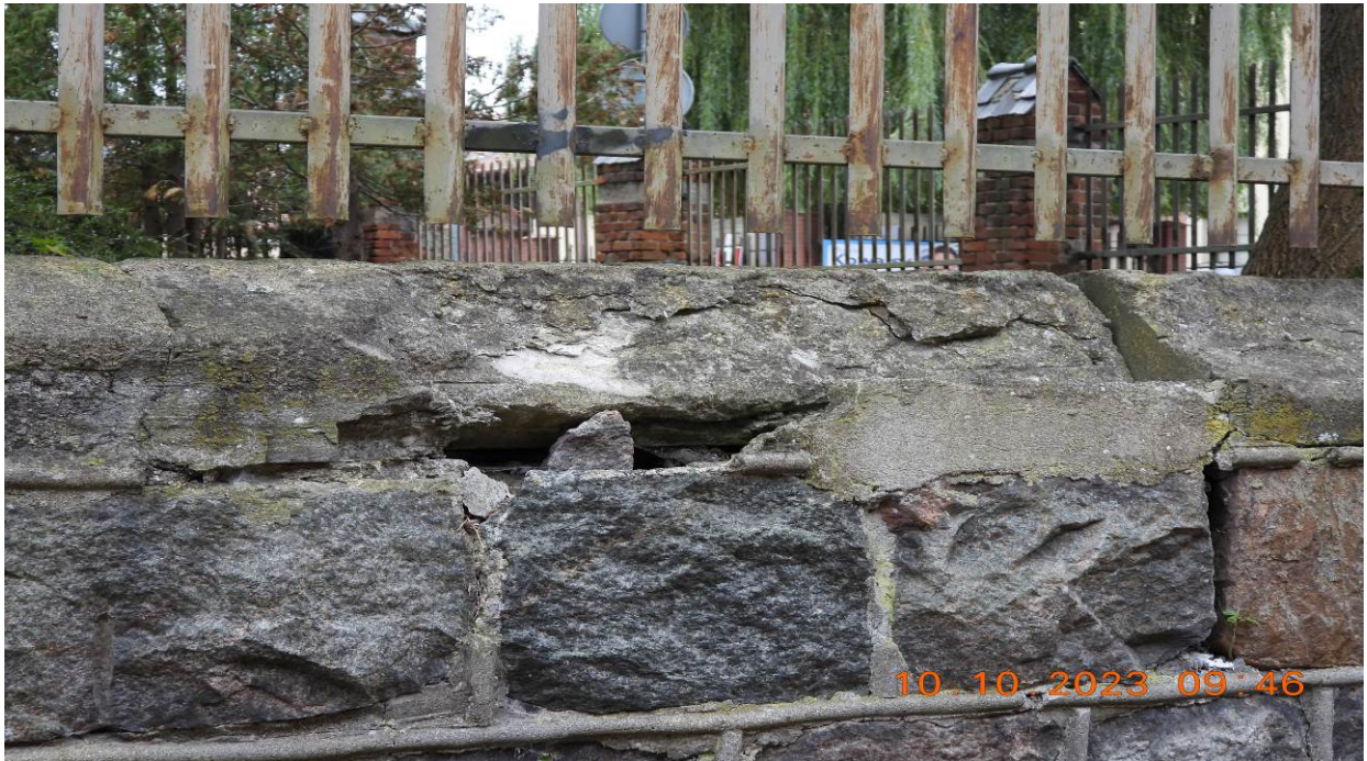
Zdjęcie nr 18. Widok uszkodzeń muru oporowego i betonowego zwieńczenia. Źródło: Zdjęcie własne.
