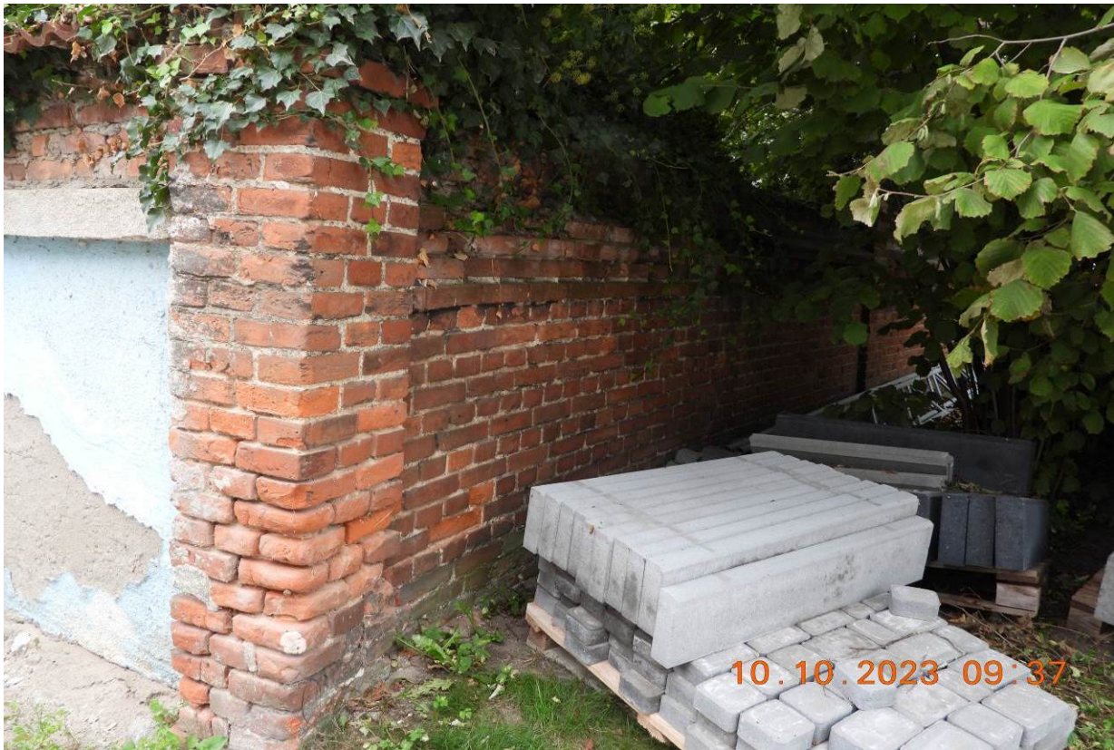
Zdjęcie nr 32. Ogrodzenie wewnętrzne szpitala. Połączenie części ceglanej z otynkowaną. Widoczne uszkodzenia oryginalnej cegły i fragment oryginalnego muru ceglanego. Źródło: Zdjęcie własne.
