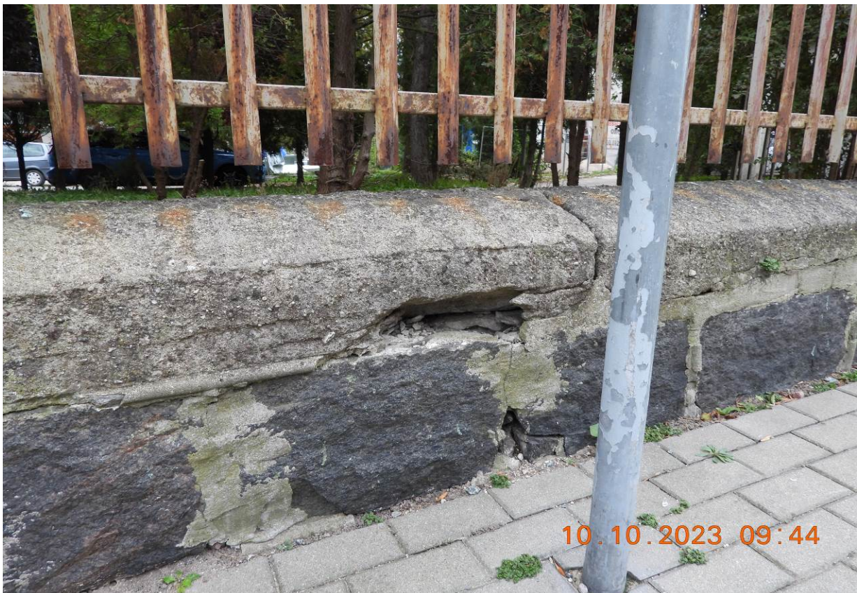
Zdjęcie nr 15. Widok uszkodzeń muru oporowego i betonowego zwieńczenia. Źródło: Zdjęcie własne.
