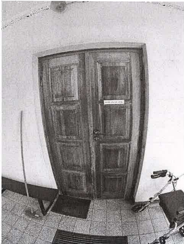
3.2 stolarka drzwiowa przeznaczona do wymiany w części mieszkalnej drzwi od strony zachodniej D1
