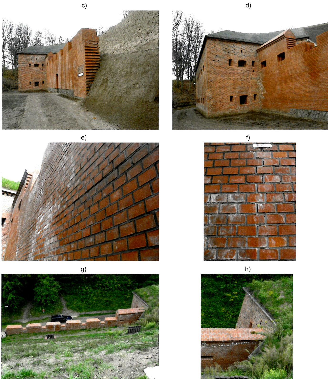
Rys.6: Mur Carnota od strony ulicy Kurkowej: a), b) podczas realizacji robót budowlanych (w latach 2008-2009), po zakończeniu robót budowlanych: c), d) w roku 2010, e), f), g) oraz h) w roku 2011, i), j), k) w roku 2013, l), m), n), o) p) oraz r) w roku 2014 (cd)
