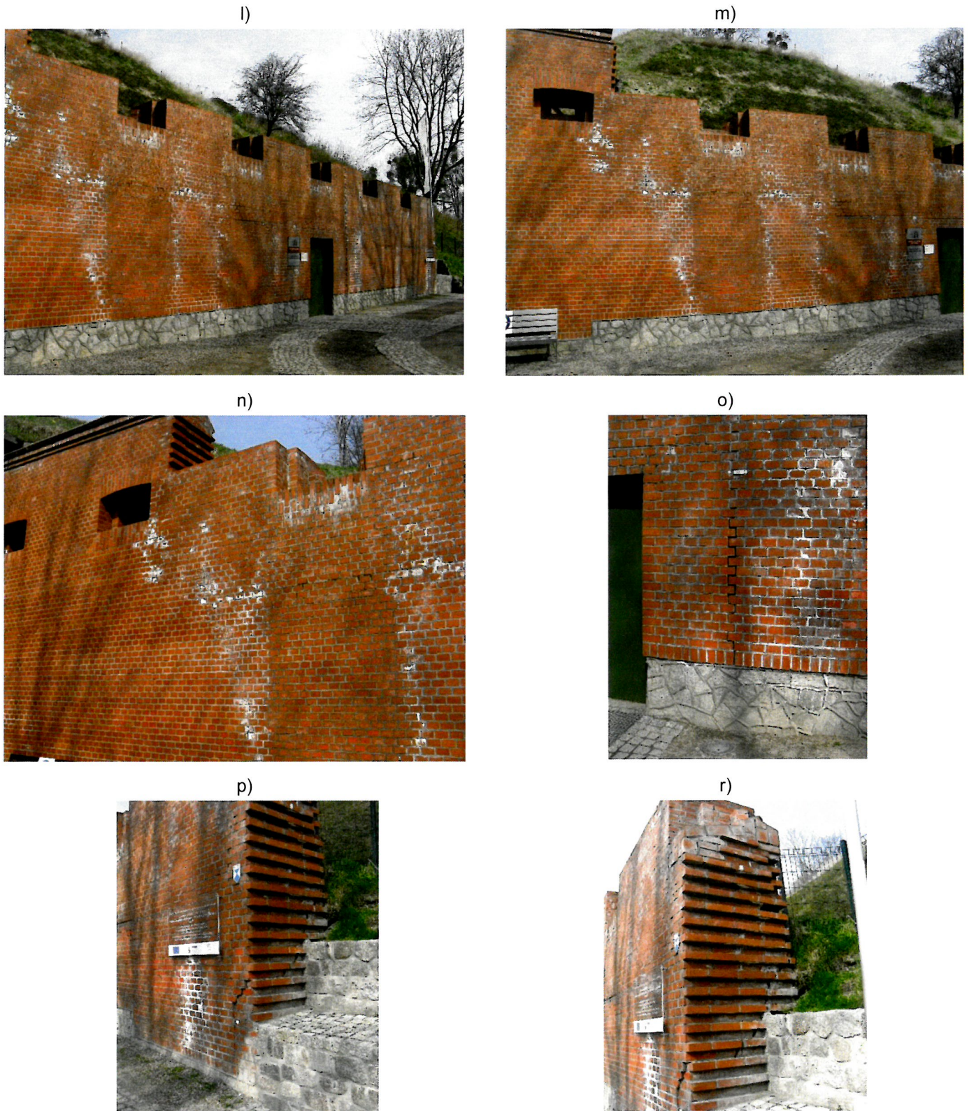
Rys.6: Mur Carnota od strony ulicy Kurkowej: a), b) podczas realizacji robót budowlanych (w latach 2008-2009), po zakończeniu robót budowlanych c), d) w roku 2010, e), f), g) oraz h) w roku 2011, i), j), k) w roku 2013, l), m), n), o) p) oraz r) w roku 2014 (cd)
