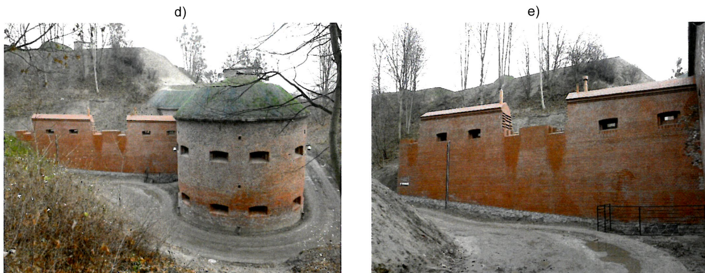
Rys.7: Mur Carnota od strony Góry Gradowej: podczas realizacji robót budowlanych: a), b), c) podczas realizacji robót budowlanych (w latach 2008-2009), c), d) po zakończeniu robót budowlanych (~2010r.) (na podstawie dokumentacji fotograficznej otrzymanej od przedstawicieli Zleceniodawcy)
