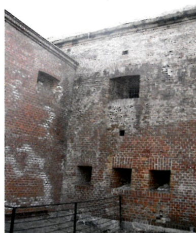
Rys.6: Mur Carnota od strony ulicy Kurkowej: a), b) podczas realizacji robót budowlanych (w latach 2008-2009), po zakończeniu robót budowlanych c), d) w roku 2010, e), f), g) oraz h) w roku 2011, i), j), k) w roku 2013, l), m), n), o) p) oraz r) w roku 2014 (cd)
