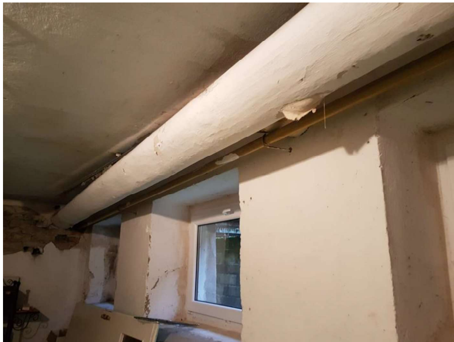
Fot. 15. Instalacja c.o. w piwnicy
