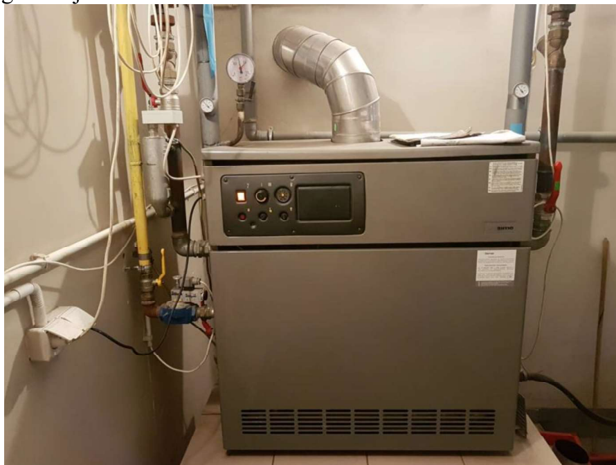
Fot. 21. Kocioł w kotłowni
