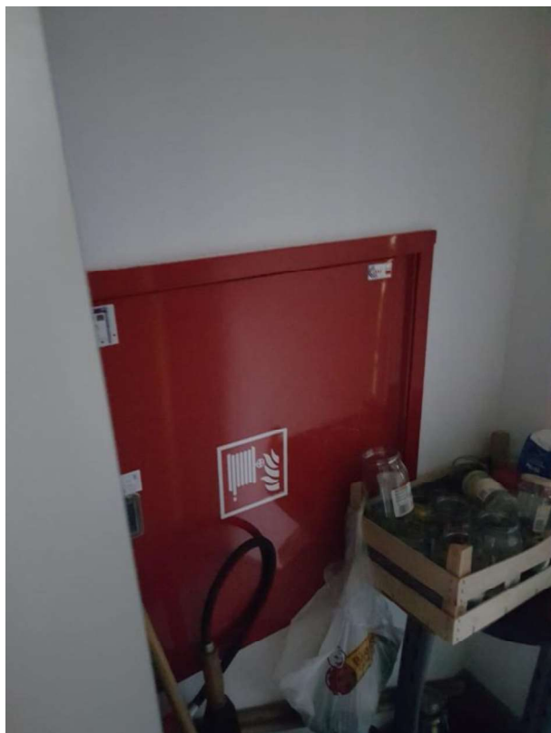
Fot. 6. Hydrant wewnętrzny dn25 podtynkowy
