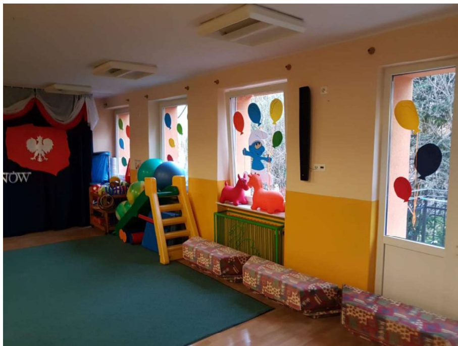
Fot. 17. Obudowane grzejniki żeliwne w sali sportowej
