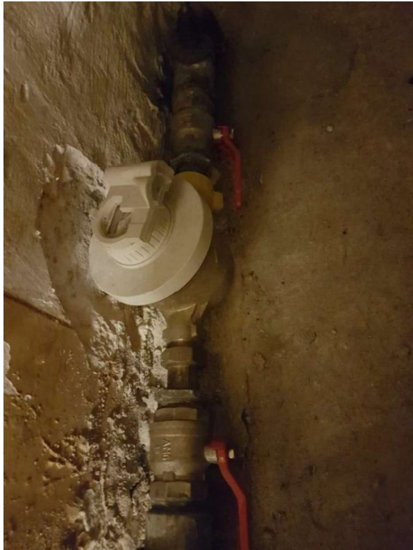
Fot. 5. Wodomierz zamontowany w budynku
