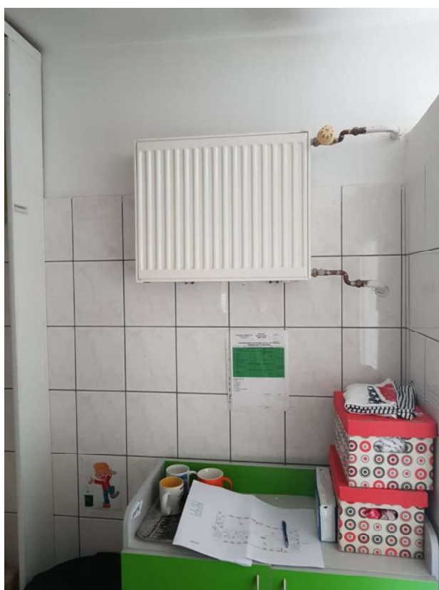
Fot. 20. Grzejnik płytowy w łazience dzieci
