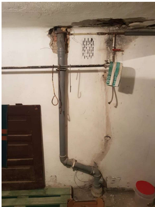
Fot. 11. Pion kanalizacji sanitarnej w piwnicy
