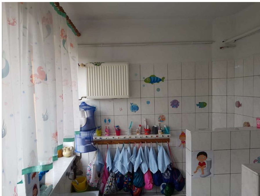
Fot. 19. Grzejnik płytowy w łazience dzieci
