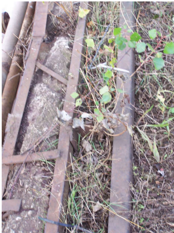
Rys. 4.3. Fragment ściany oporowej ze stalową opaską
