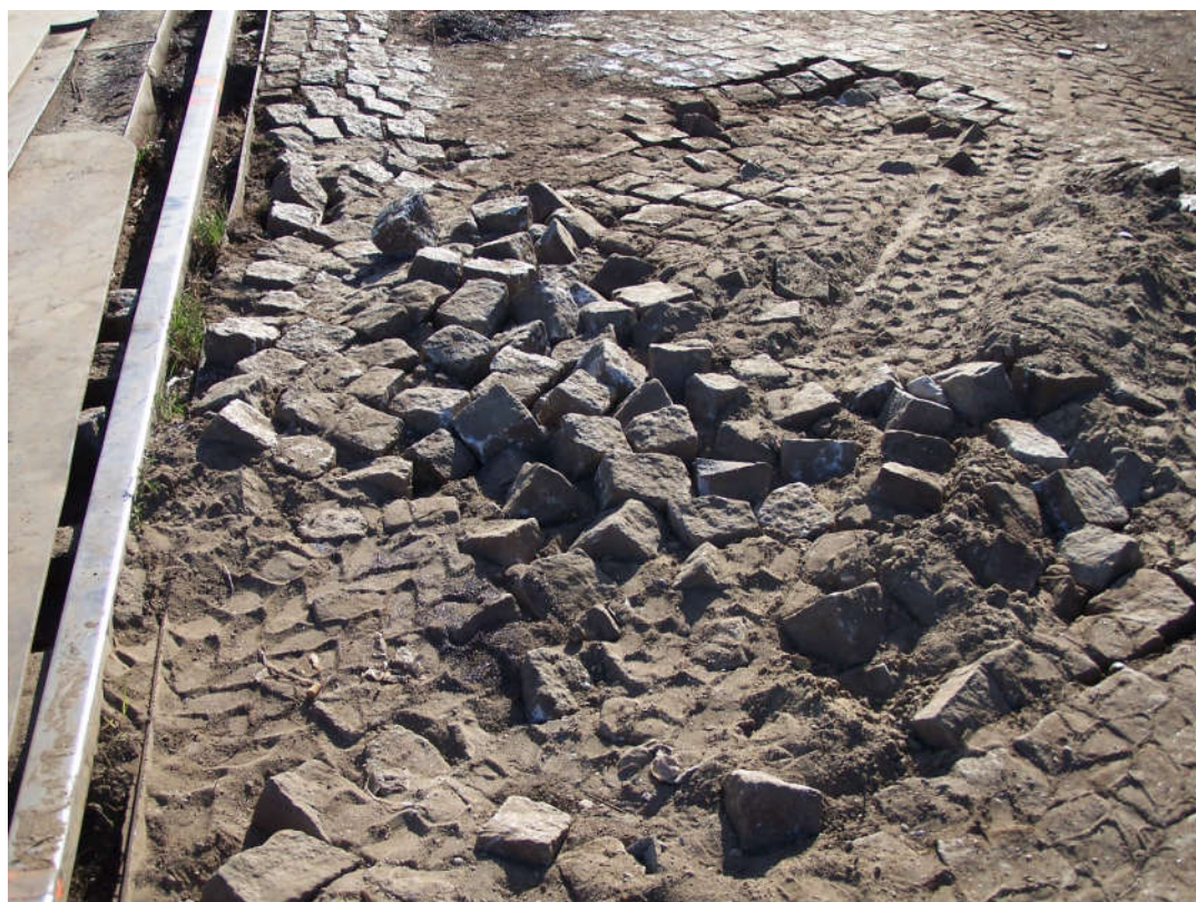
Rys. 4.12. Ubytki i zniszczenie nawierzchni kostkowej
