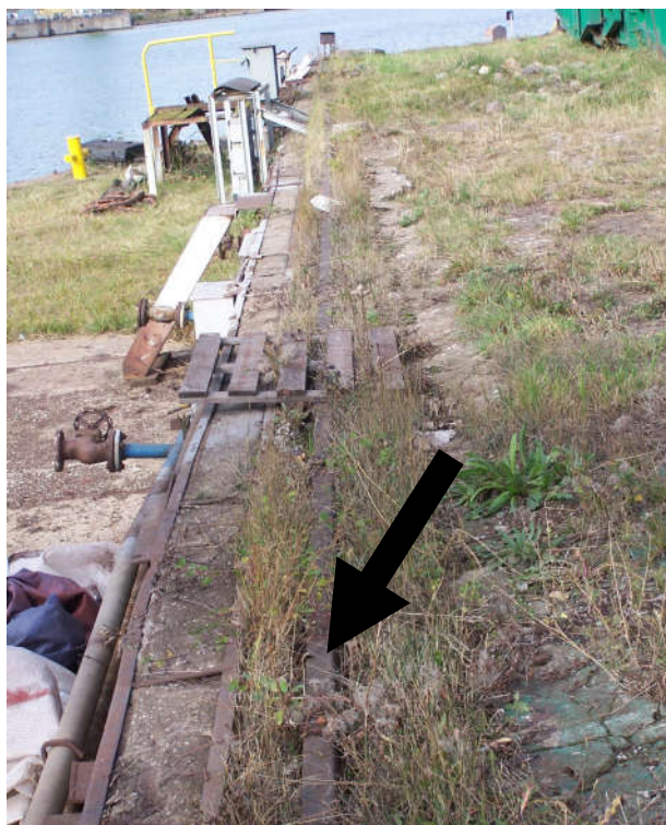
Rys. 4.3. Widok na starą nieużywaną szynę
