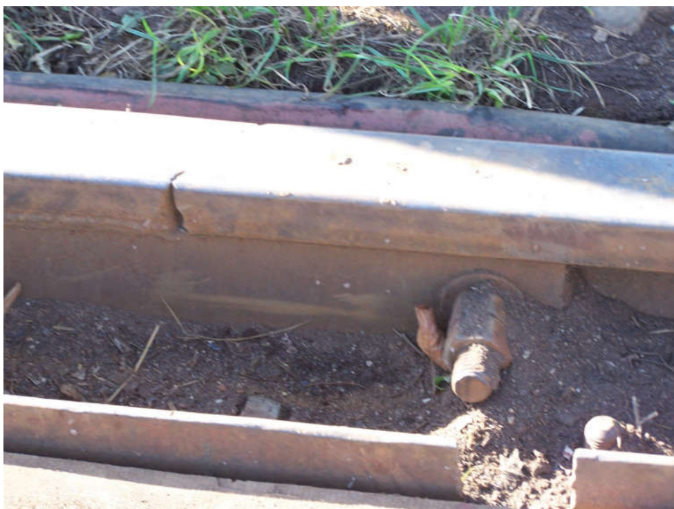
Rys. 4.19. Szyna lubkowana w miejscu pęknięcia
