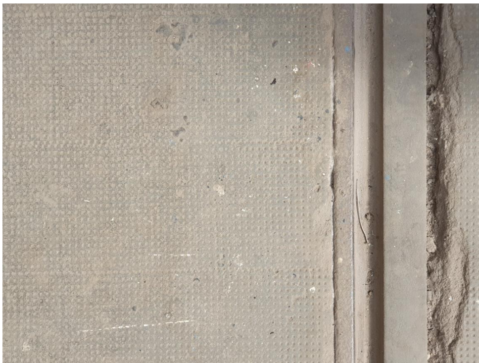
Charakterystyczna struktura posadzki hali nr 2 – odcisk „GOFRA”.
