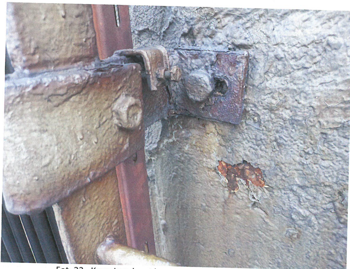
Fot. 23. Korozja uchwytów mocowania drabiny wejściowej
