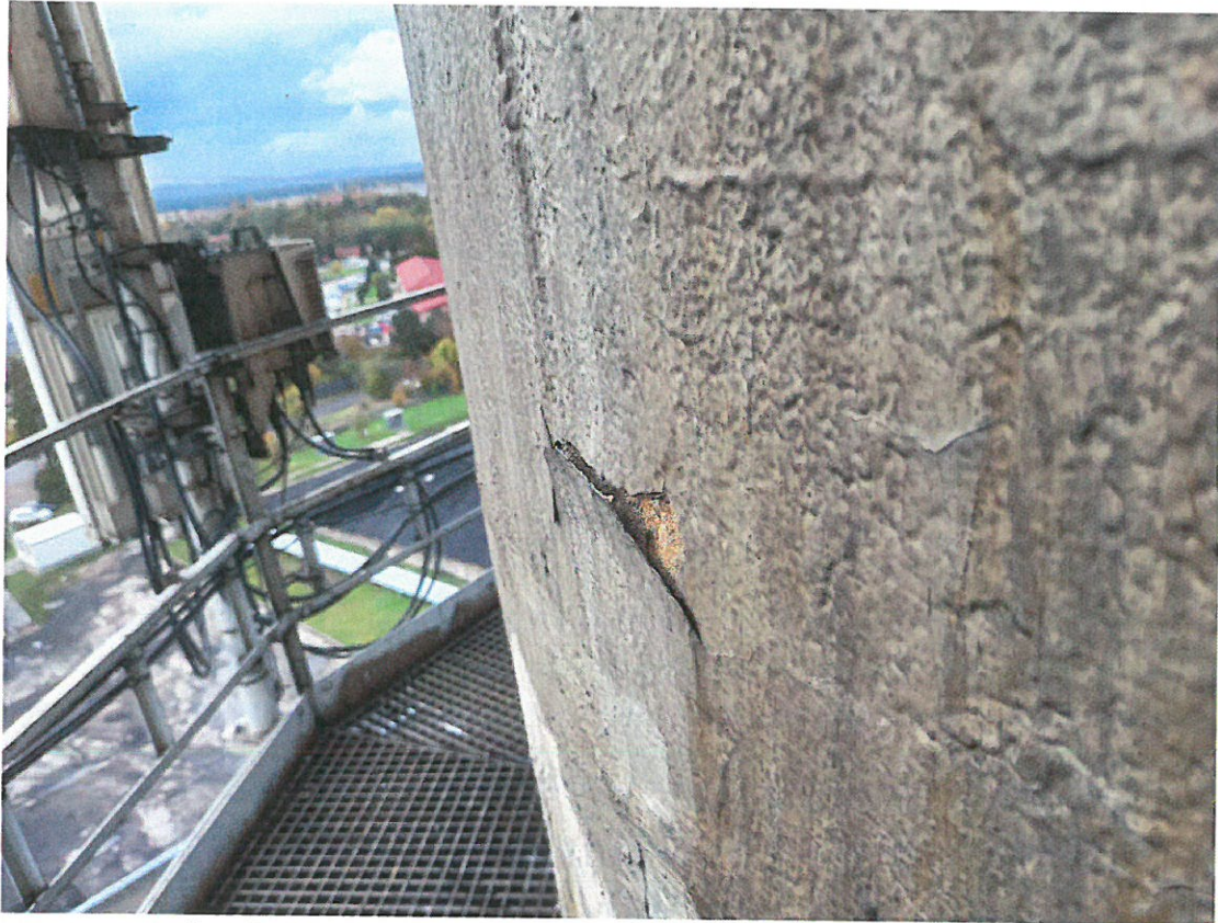
Fot. 5. Poziome rysy i odspojenia warstwy zabezpieczającej.
