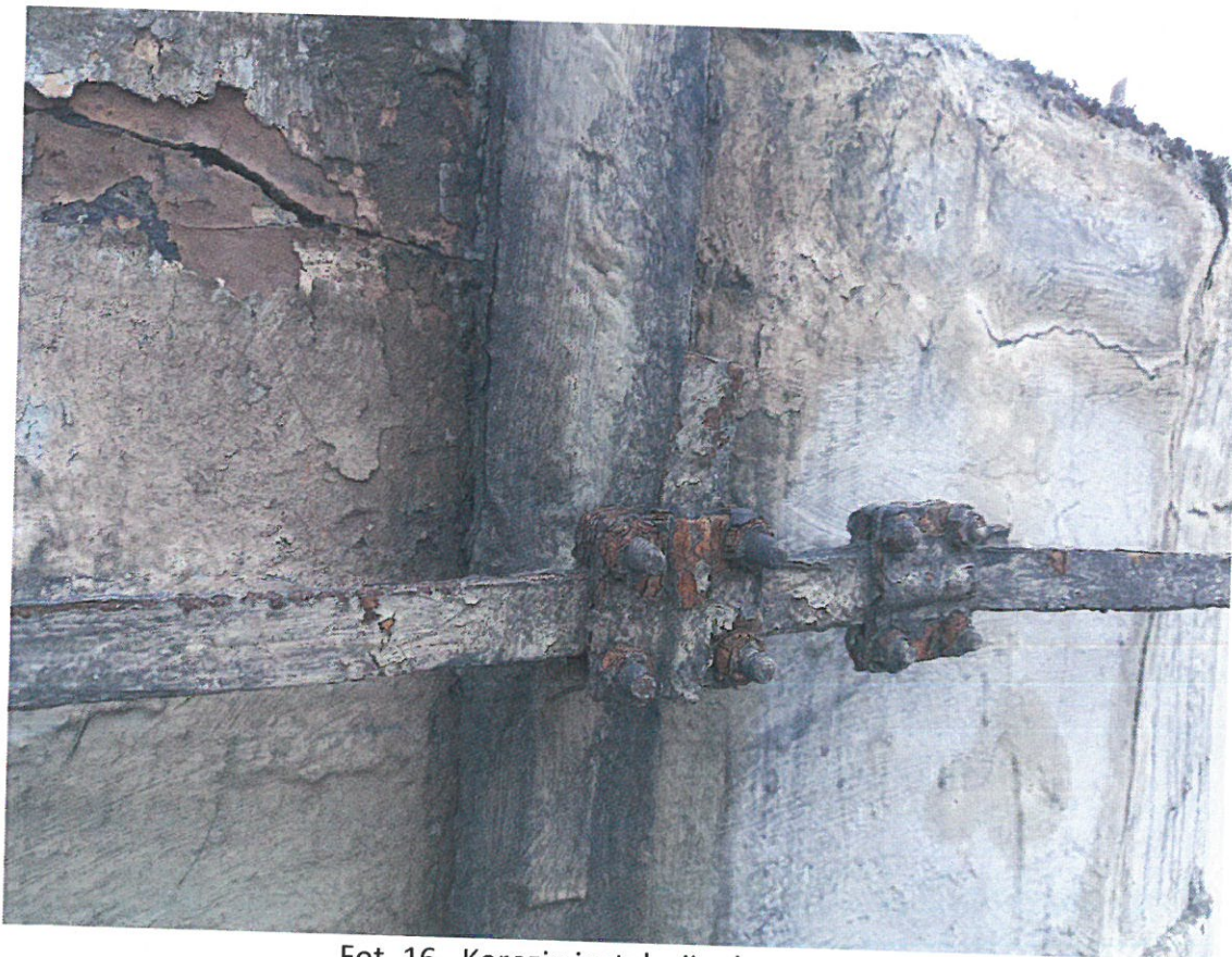
Fot. 15. Korozja mocowania obejm i konieczność pilnej wymiany śrub
