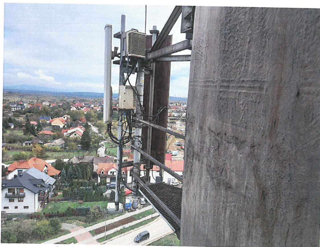
Fot. 22. Nalot korozji na konstrukcjach wsporczych anten
