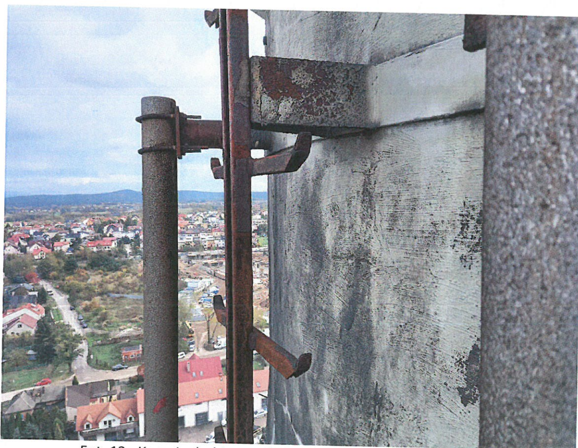
Fot. 12. Korozja drabiny asekuracyjnej Soll i wsporników anten
