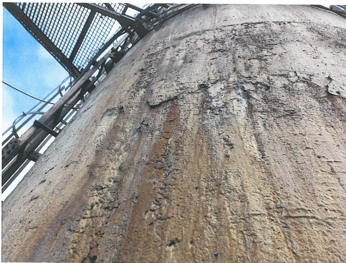
Fot. 3. Odspojenia warstwy zabezpieczającej.
