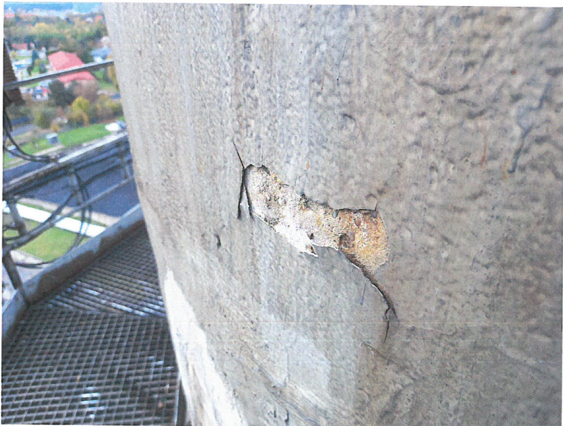
Fot. 6. Odspojenia warstwy zabezpieczającej.
