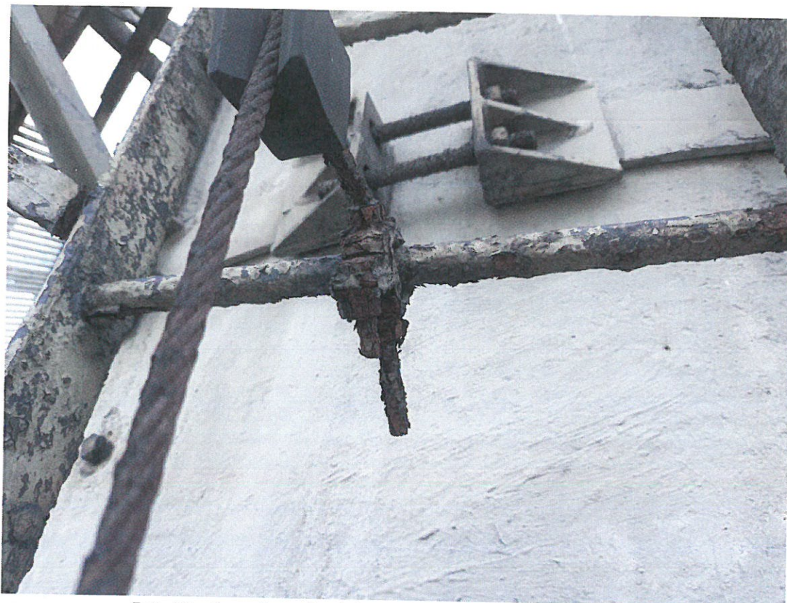
Fot. 21. Korozja pośredniego chwytaka linki asekuracyjnej
