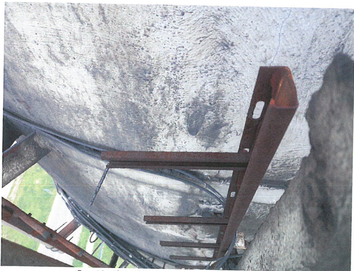
Fot. 10. Skorodowany element drabiny kablowej
