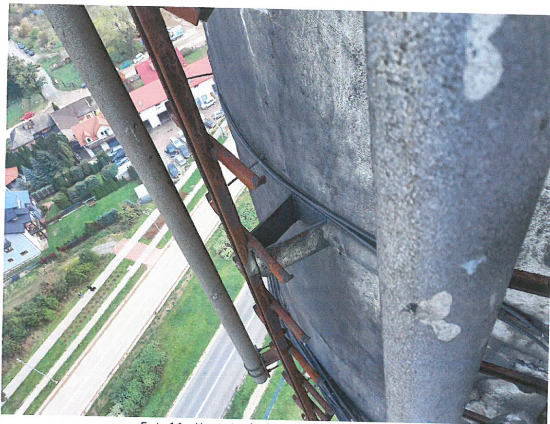
Fot. 11. Korozja drabiny asekuracyjnej Soll
