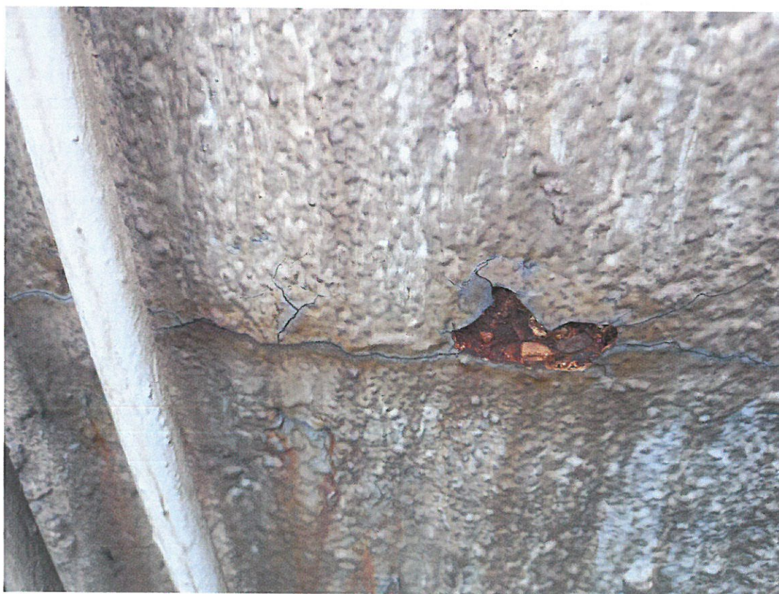
Fot. 4. Poziome rysy i odspojenia warstwy zabezpieczającej.
