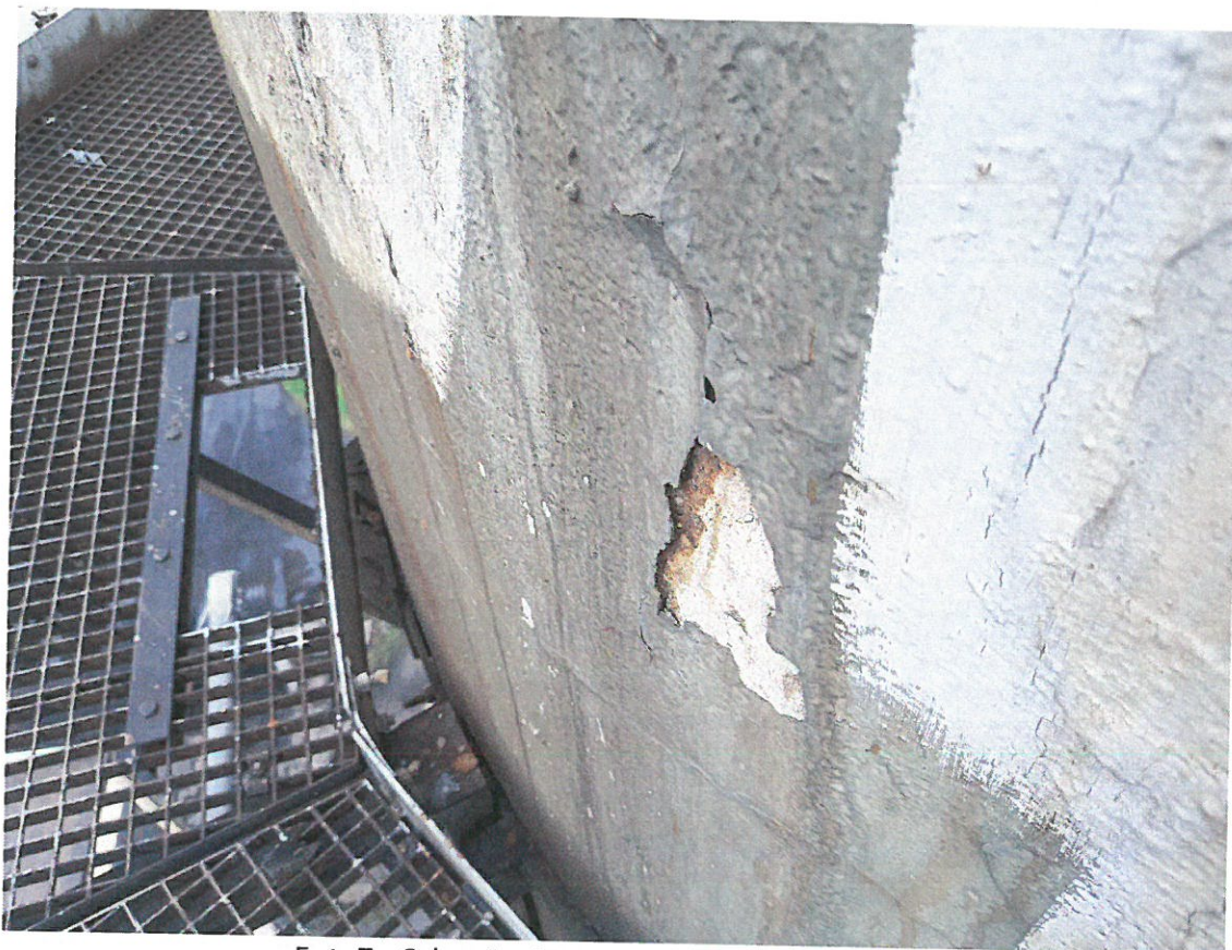
Fot. 7. Odspojenia warstwy zabezpieczającej.
