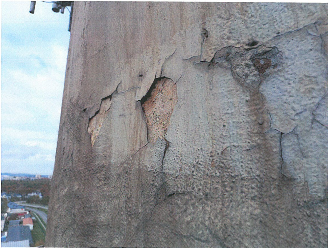
Fot. 2. Odspojenia warstwy zabezpieczającej.
