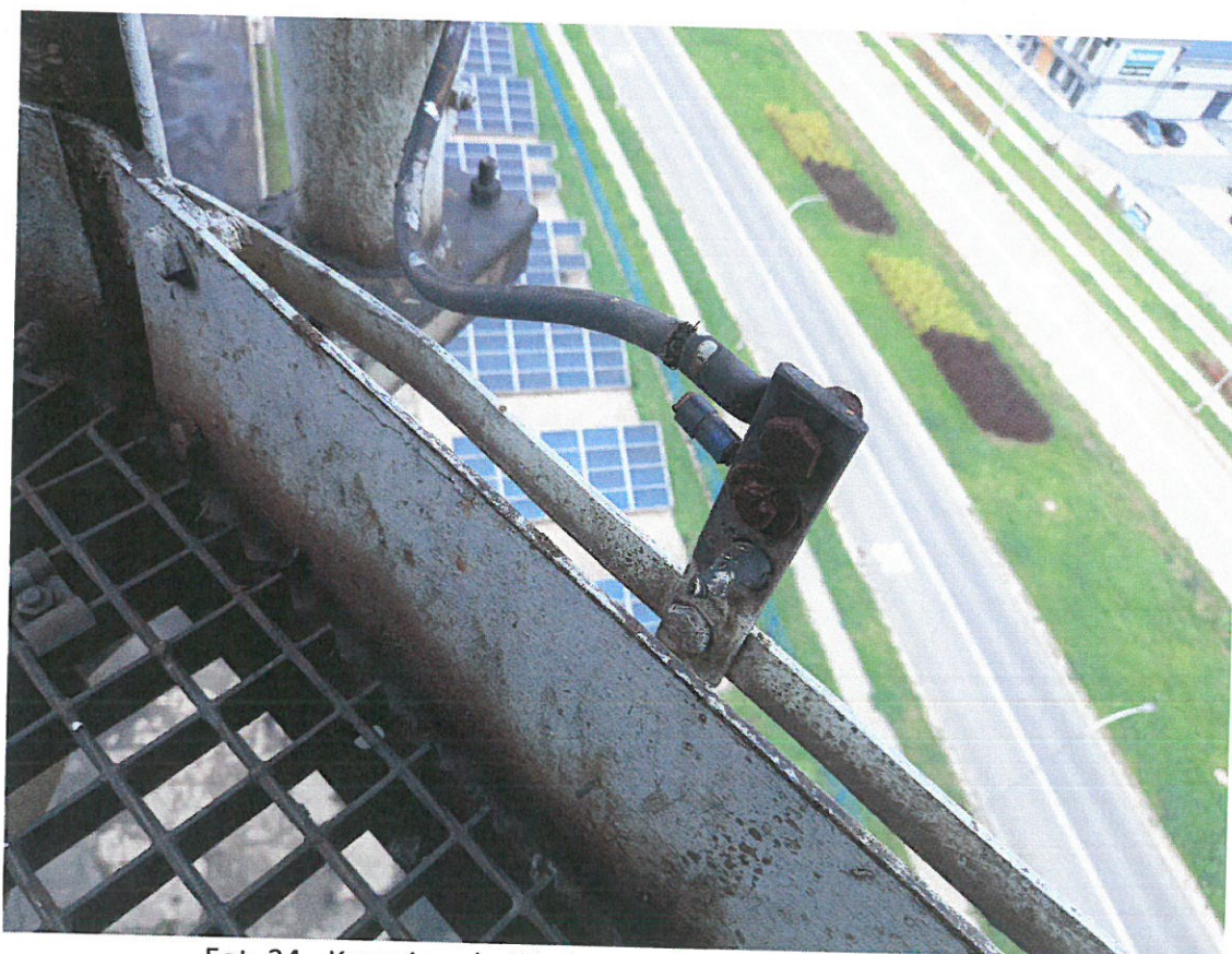
Fot. 24. Korozja galerii i elementów instalacji uziemiającej
