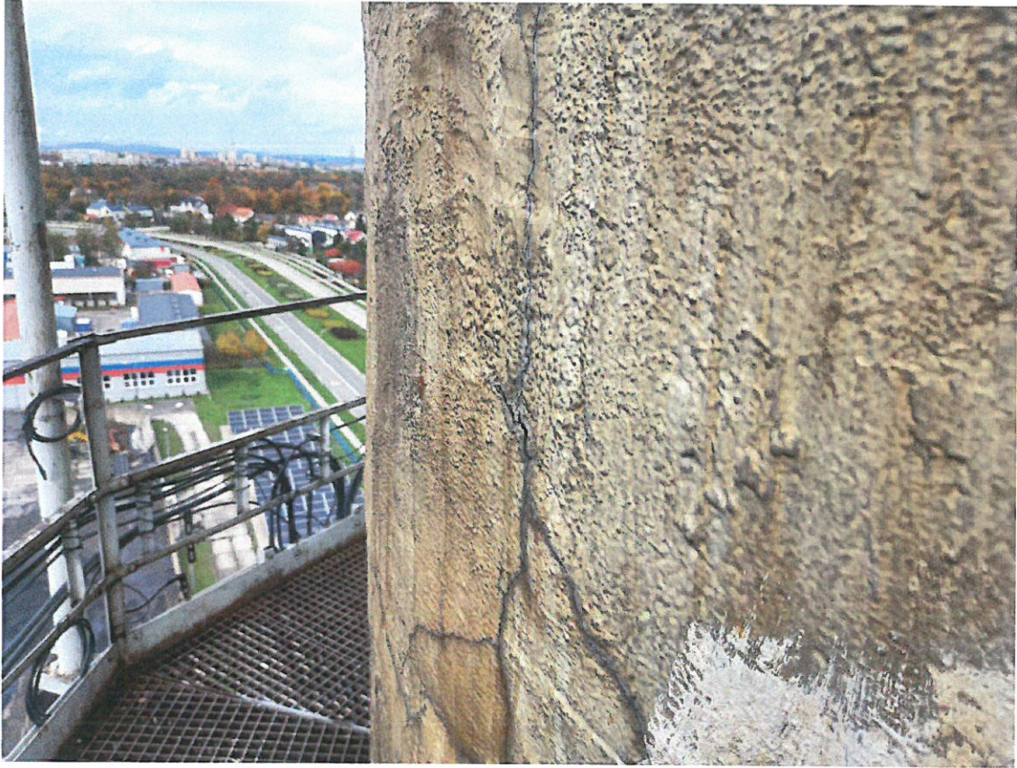
Fot. 1. Widoczne zarysowania płaszcza komina.
