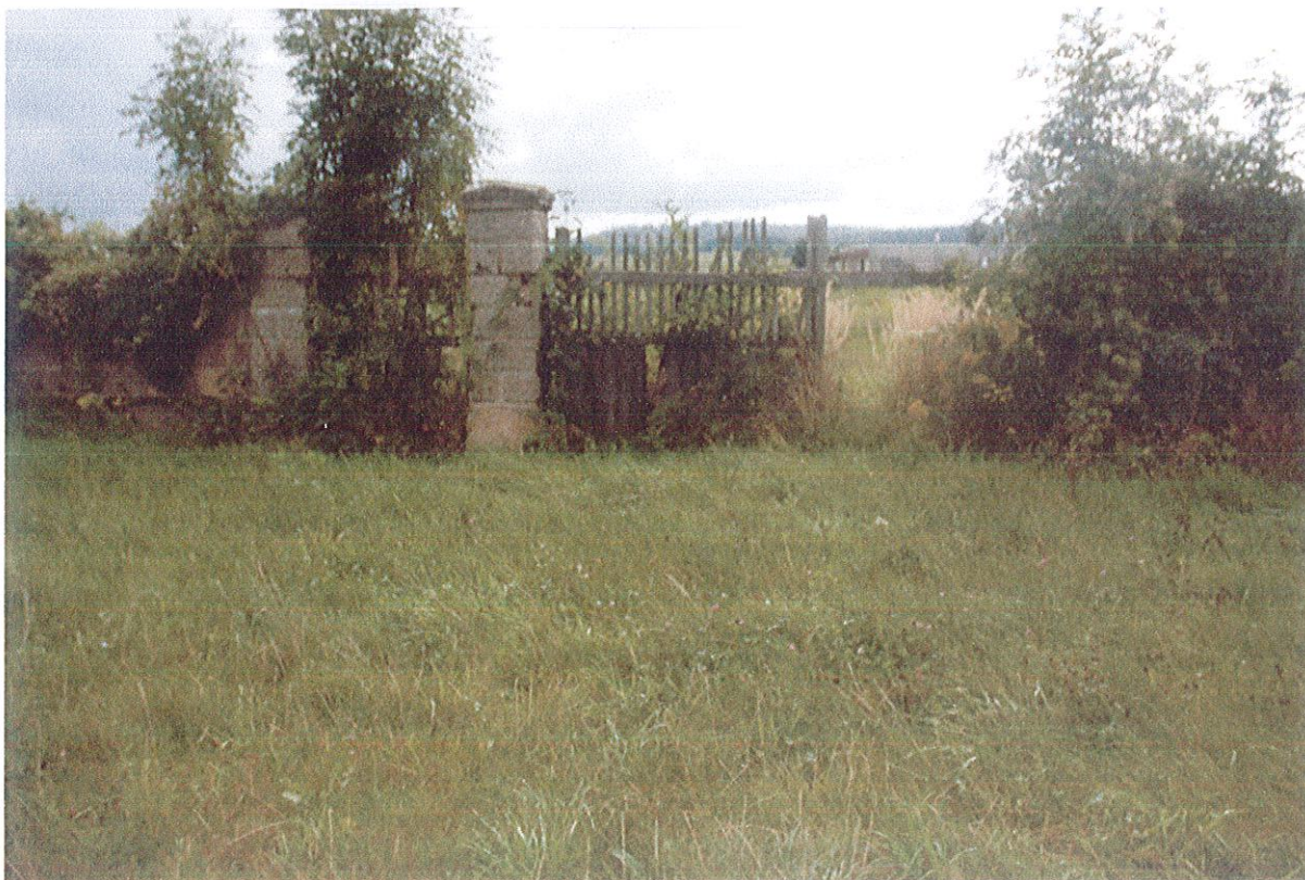
Fot. 1. Drewniana furtka i brama wjazdowa: zły stan.
