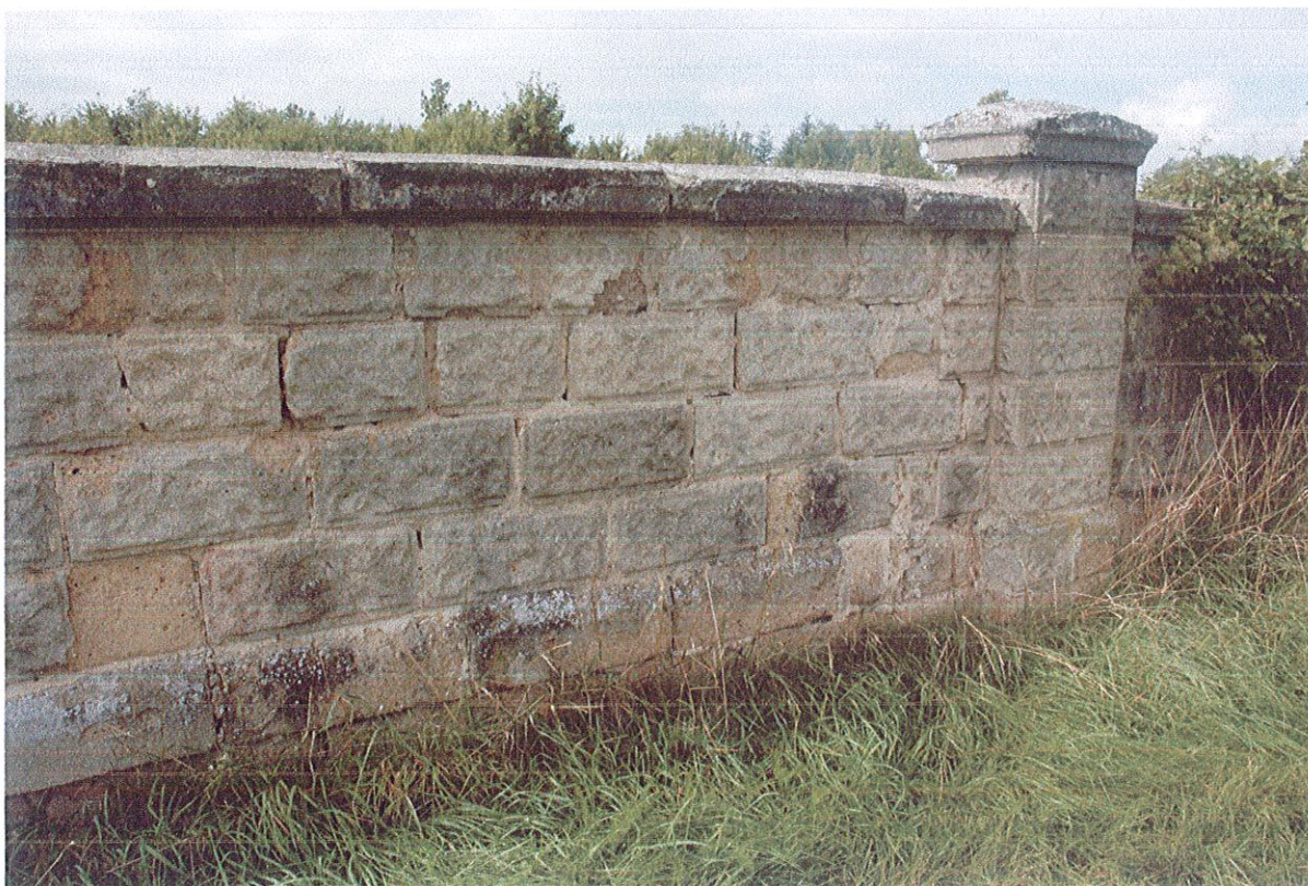
Fot.3. Widok muru od zewnątrz. Betonowe pustaki z którego zbudowany jest mur są w złym stanie. Beton stracił wytrzymałość.
