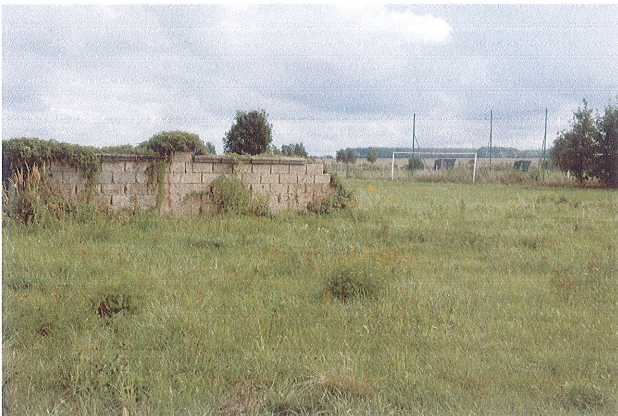
Fot. 2. Ubytek ogrodzenia. Mur rozebrany na długości 25,0-30,0m
