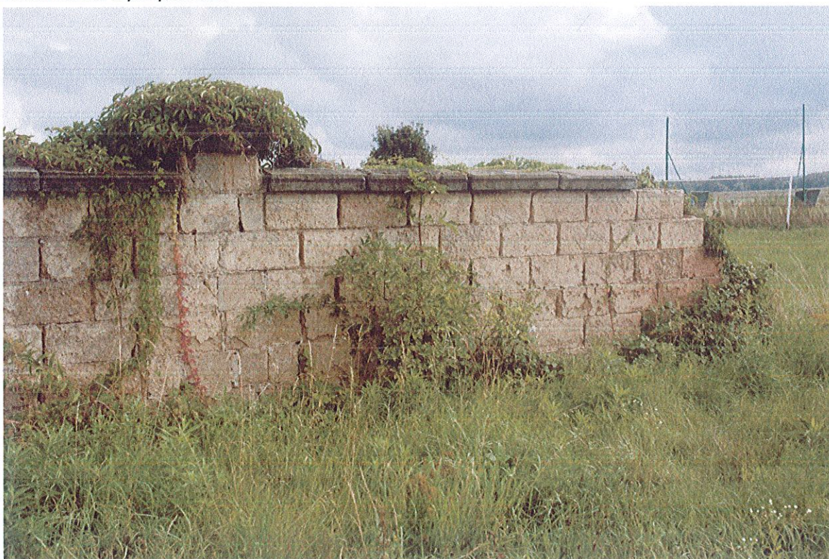
Fot.3. Widok muru od zewnątrz. Betonowe pustaki z którego zbudowany jest mur są w złym stanie. Beton stracił wytrzymałość.
