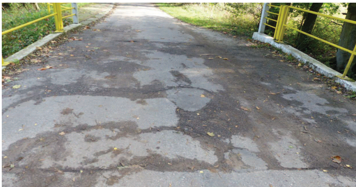
Fot. 14 Nawierzchnia jezdni
