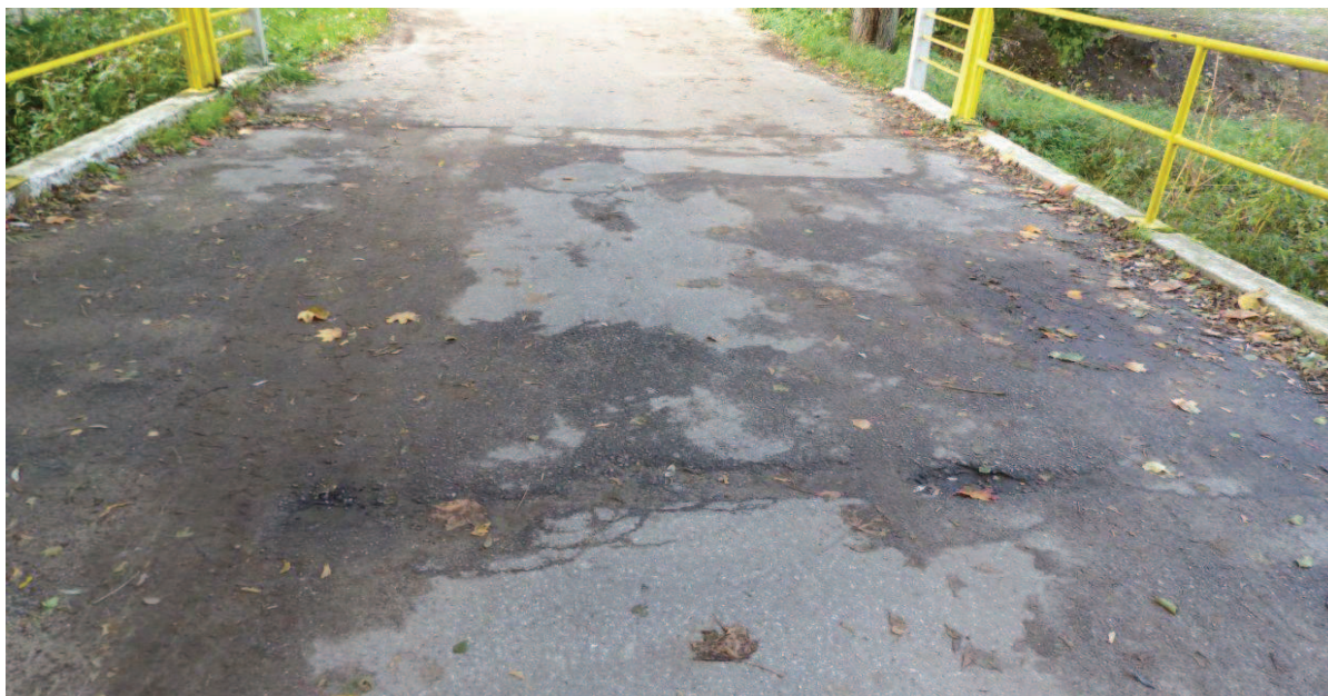
Fot. 13 Nawierzchnia jezdni
