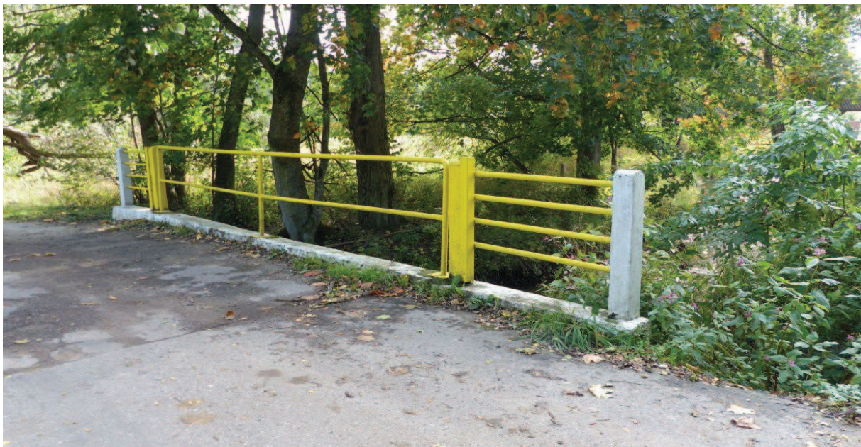
Fot. 16 Nawierzchnia chodników, krawężniki most bez wydzielonej konstrukcji chodnika
