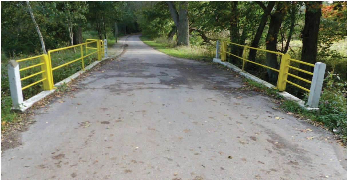
Fot. 21 Urządzenia odwadniające
