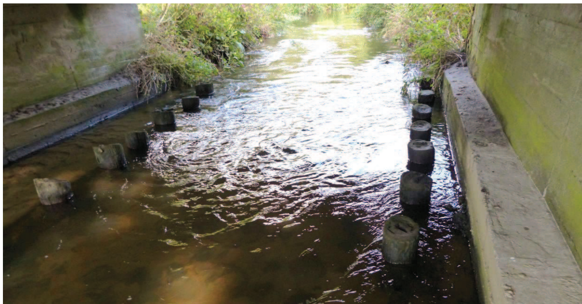
Fot. 31 Koryto rzeki, przestrzeń podmostowa nadmierna wegetacja roślin utrudniająca przepływ wody
