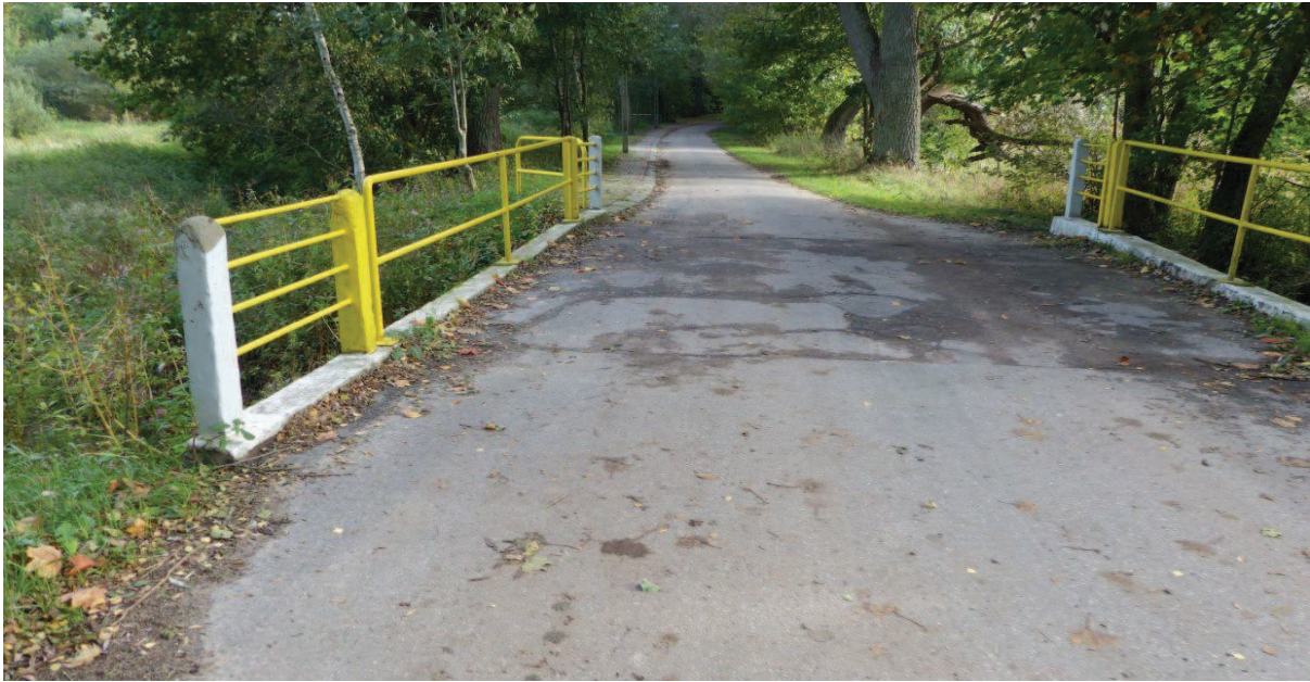
Fot. 15 Nawierzchnia chodników, krawężniki most bez wydzielonej konstrukcji chodnika
