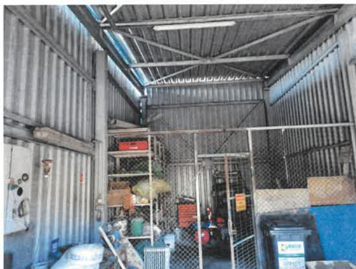
Fot.6 Wiata magazynowa – widok konstrukcji
