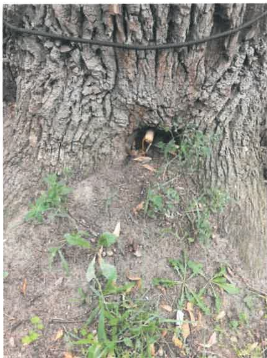
fot. 4 Ubytek pomiędzy nabiegami
