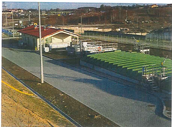
Podczyszczalnia ścieków i odcieków
