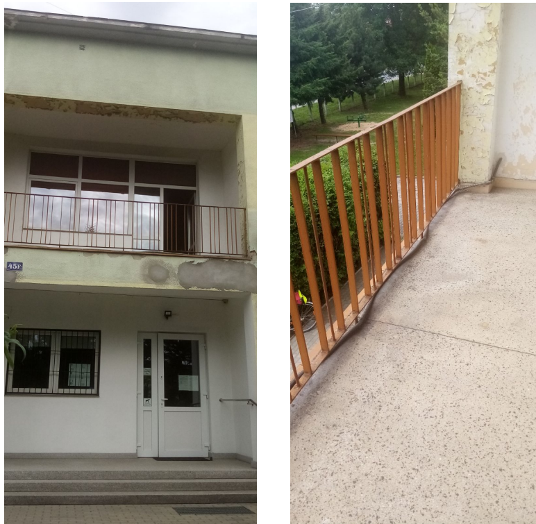
Fot. 3.17. Istniejąca barierka balkonowa na frontowej ścianie szkoły.
