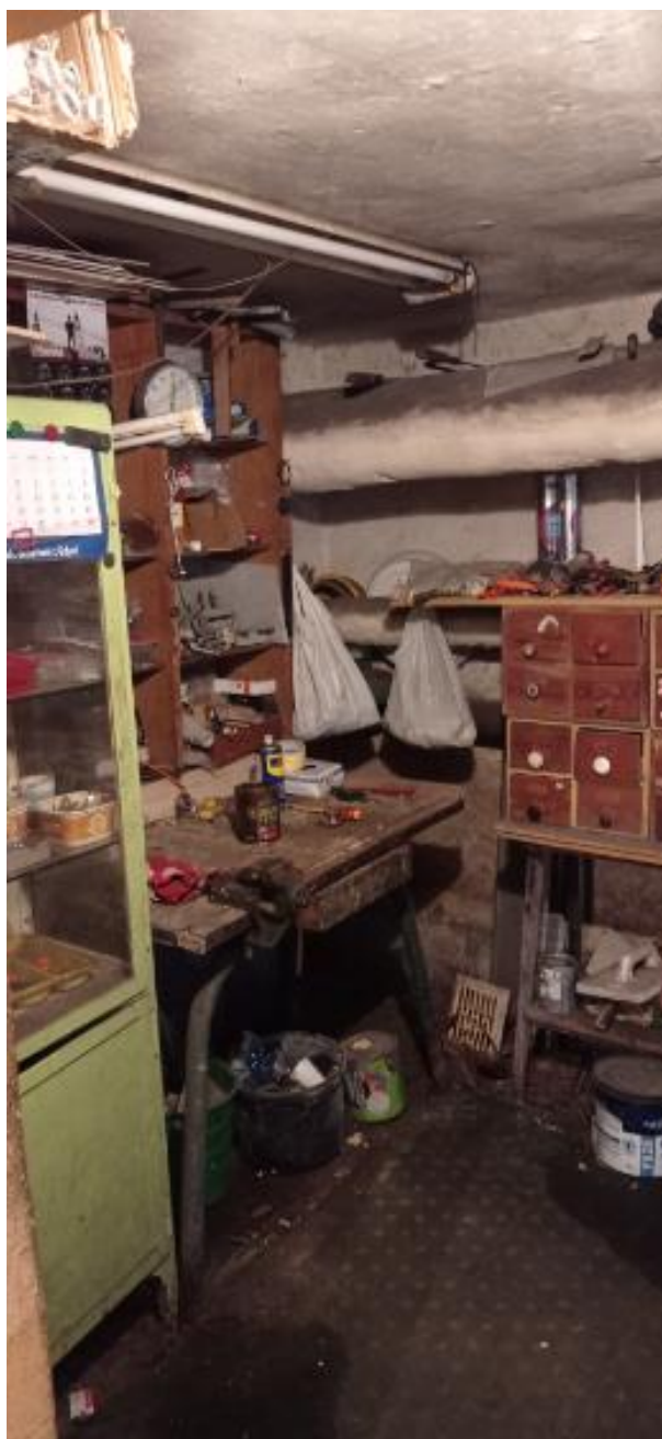
Fot. 3.7. Istniejące źródło ciepła dla budynku szkoły i biblioteki.
