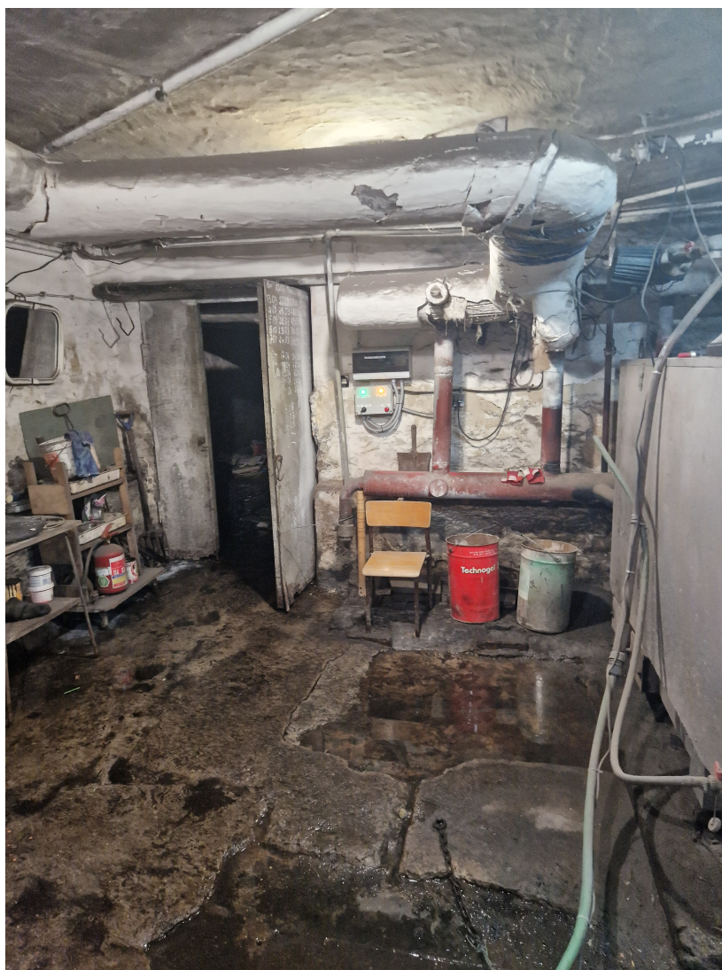
Fot. 3.4. Istniejące źródło ciepła dla budynku szkoły i biblioteki.
