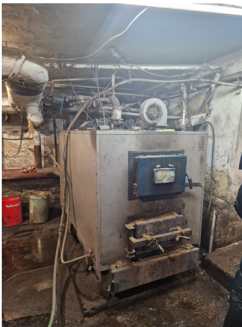
Fot. 3.3. Istniejące źródło ciepła dla budynku szkoły i biblioteki.
