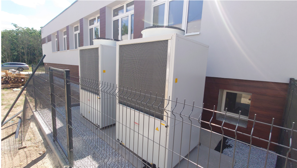
Fot. 3.19. Widok przykładowego montażu kaskady pomp ciepła.
