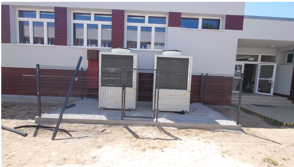
Fot. 3.18. Widok przykładowego montażu kaskady pomp ciepła.
