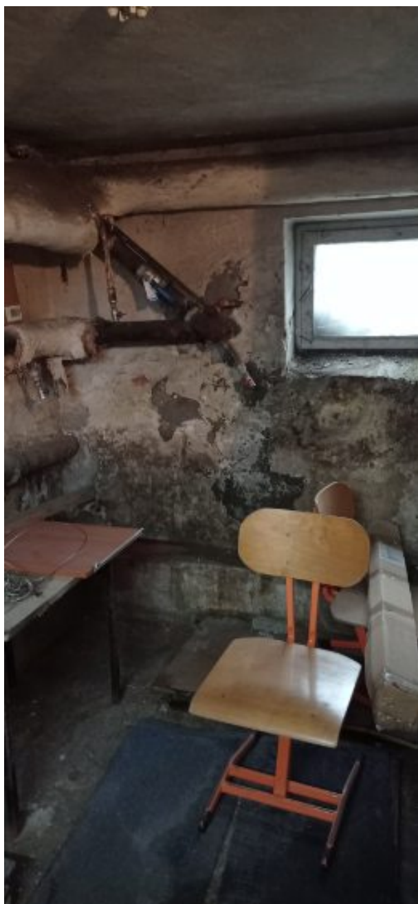
Fot. 3.8. Istniejące źródło ciepła dla budynku szkoły i biblioteki.
