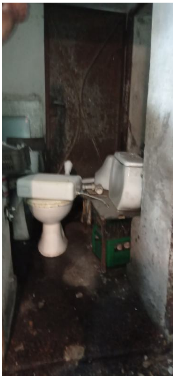
Fot. 3.12. Istniejące źródło ciepła dla budynku szkoły i biblioteki.
