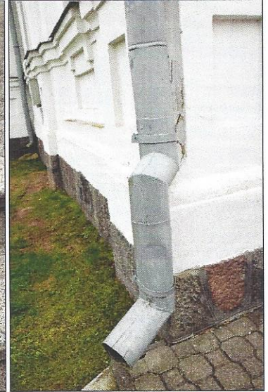
Bardzo zniszczone rury spustowe
