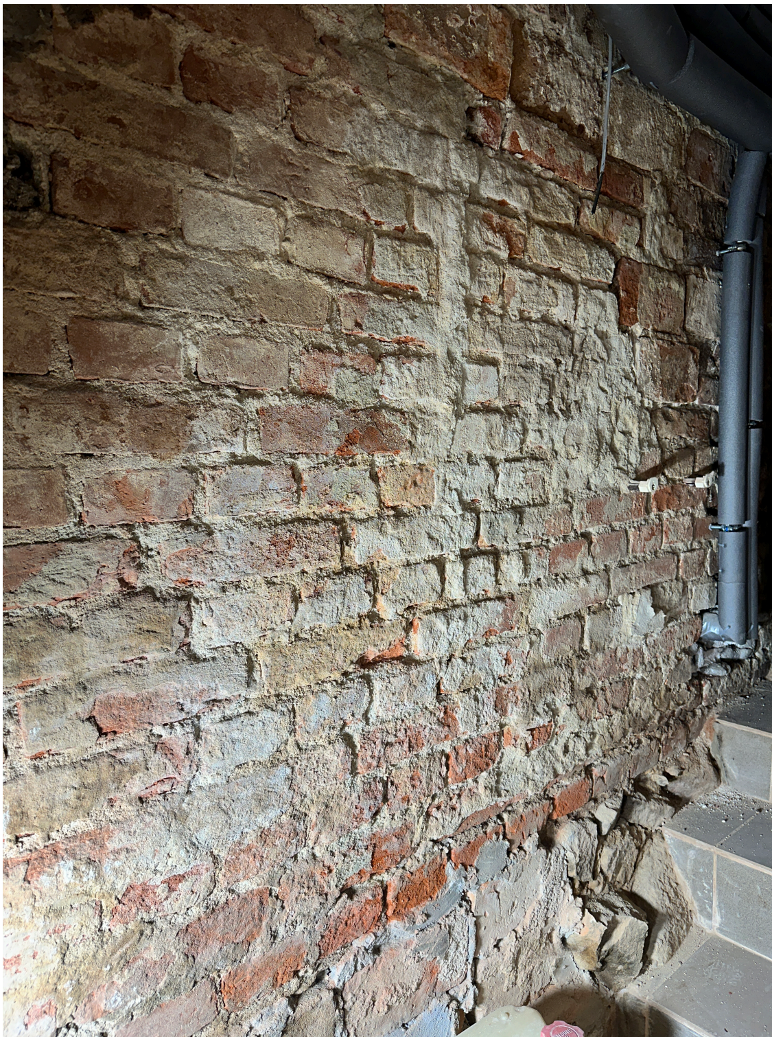
Fot. 5 Obiekt przed konserwacją - fragment lica muru ceglanego wraz z wtórnymi, nieprawidłowo przeprowadzonymi naprawami. Ściana zaatakowana mikro-biologicznie - na jej powierzchni występują trwałe nawarstwienia i liczne sole, które krystalizują na powierzchni cegły.
