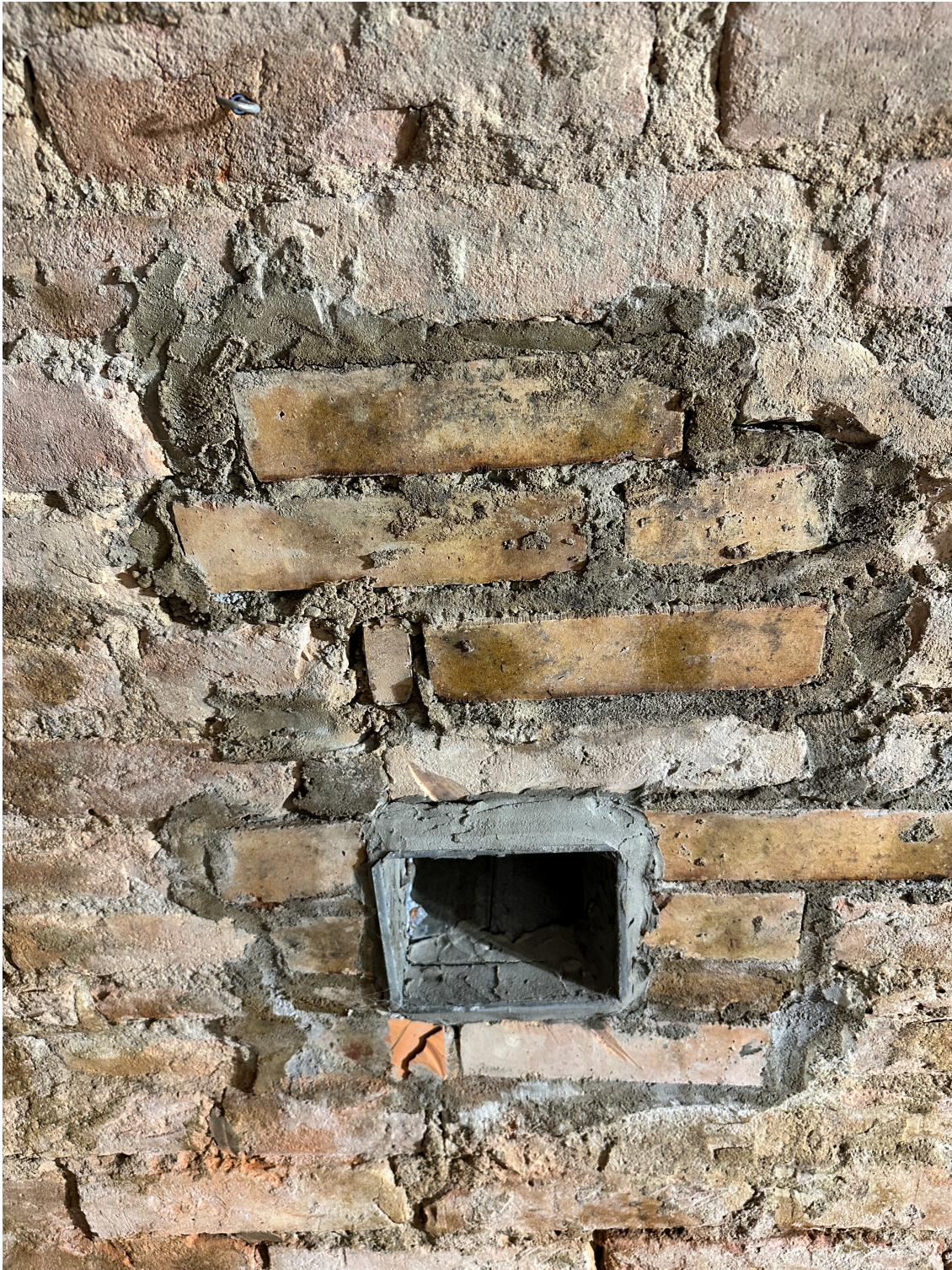
Fot. 13 Obiekt przed konserwacją. Zdjęcie obrazujące nieprawidłowy sposób przemurowania wątku ceglanego z zastosowaniem zaprawy cementowej.
