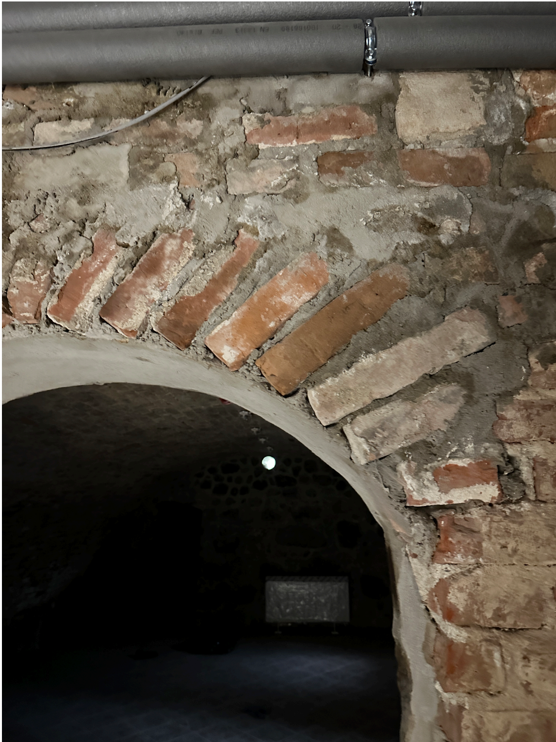
Fot. 14 Obiekt przed konserwacją – fragment skandalicznej rekonstrukcji sklepienia ceglanego łuku sklepiennego nad otworem wyjściowym
