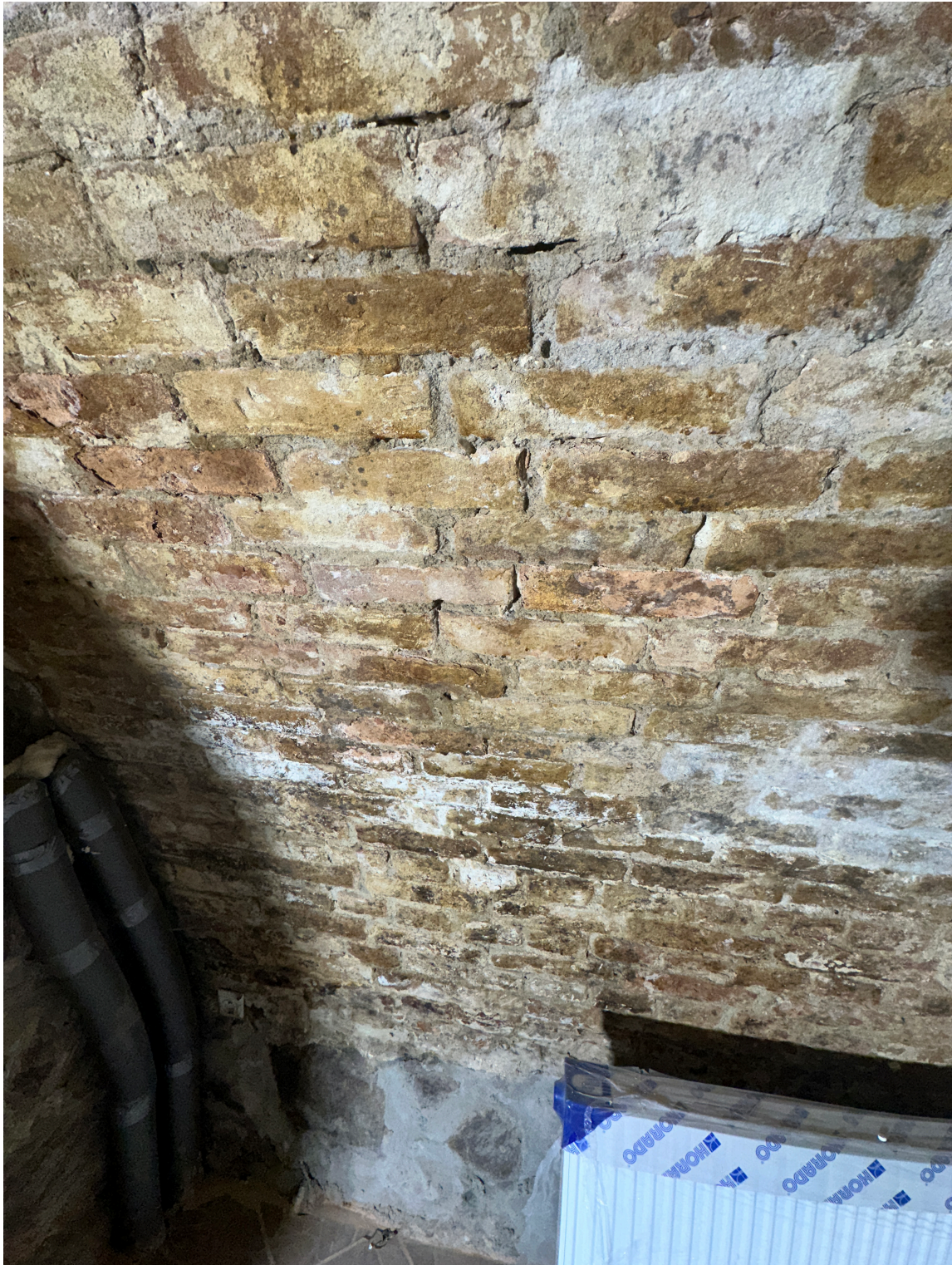
Fot. 6 Obiekt przed konserwacją - zdjęcie obrazuje bardzo zły stan zachowania ścian piwnic, w dolnej partii widoczne niefachowe naprawy przyczyniające się do pogorszenia stanu obiektu.
