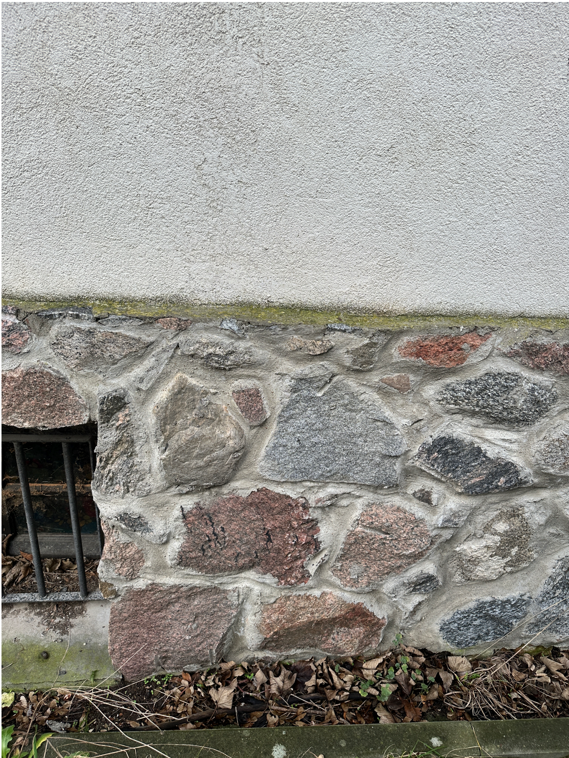
Fot. 10 Zewnętrzny cokół kamienny wykonany z otoczków granitowych, nieprawidłowo wyspoinowany przy pomocy zapraw cementowych. Obiekt przed konserwacją.
