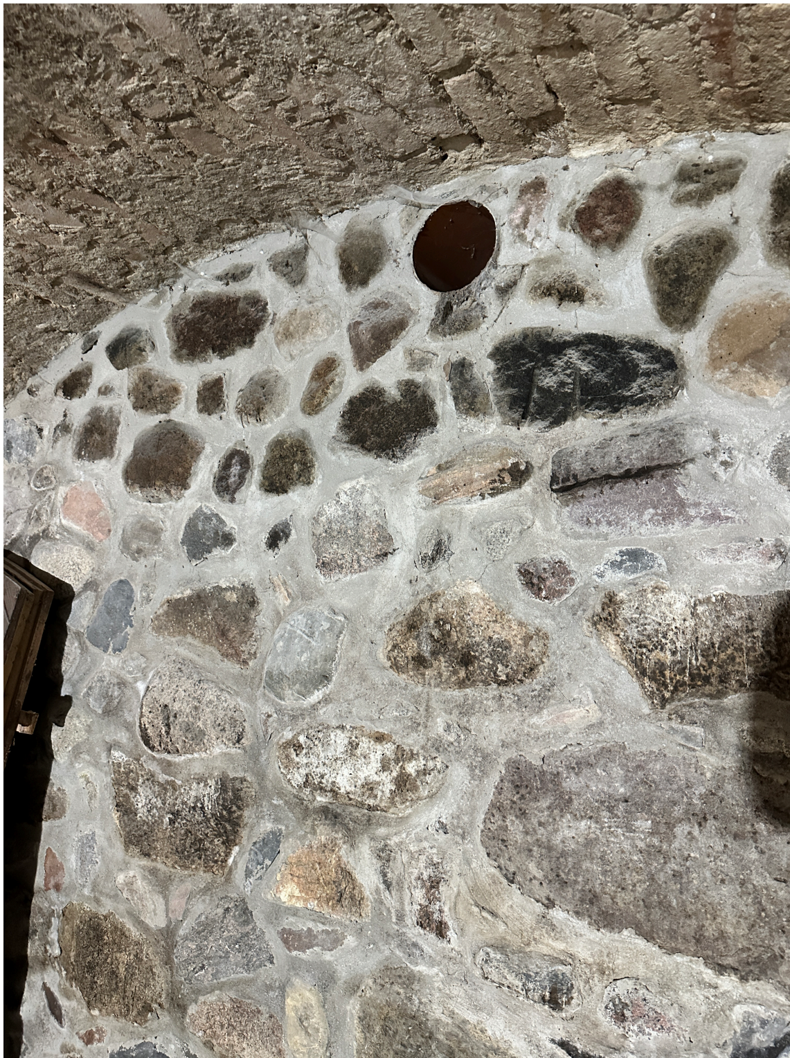
Fot. 8 Przykład zniszczenia obiektu polegający na zastosowaniu spoiny cementowej do fugowania wątku kamiennego. Zastosowanie cementu powoduje trwałe uszczelnienie, wprowadzanie soli rozpuszczalnych do obiektu oraz psuje estetykę historycznego wystroju.
