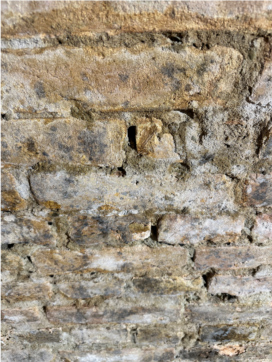
Fot. 11 Zdjęcie obrazujące licznie nawarstwienia, sole, żerowiska mikrobiologiczne na licu muru ceglanego. Obiekt przed konserwacją.
