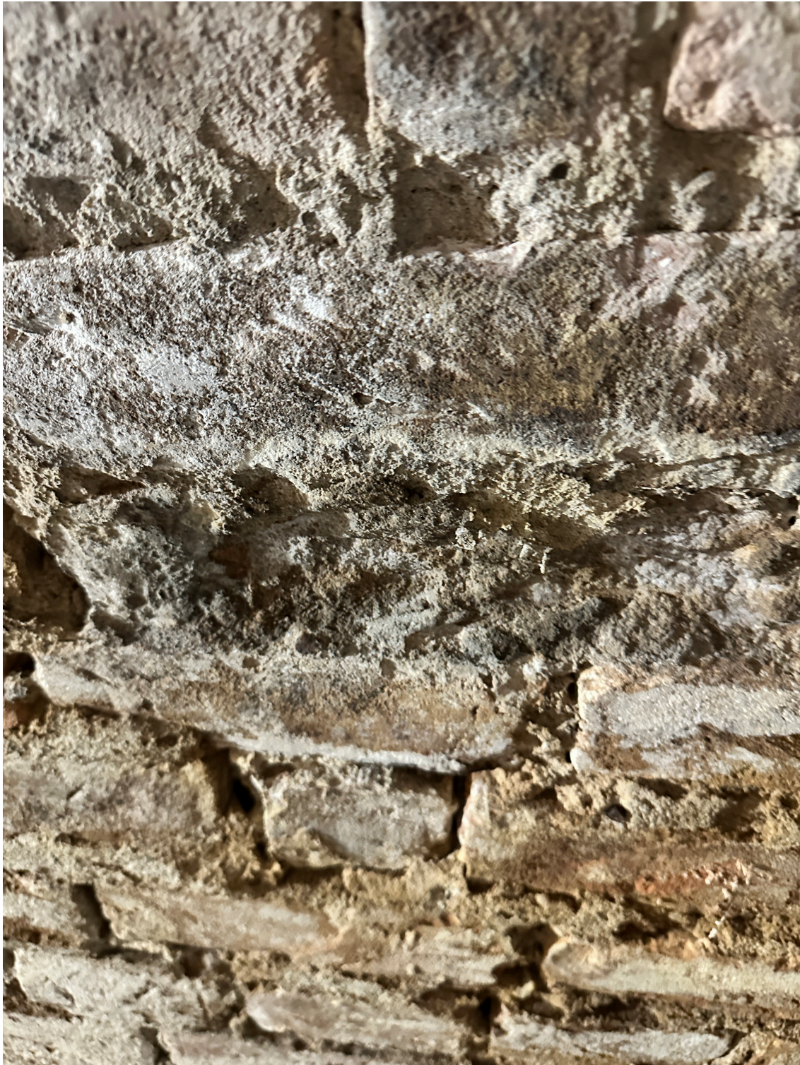
Fot. 15 Silna destrukcja cegły z wyraźnymi wykwitami solnymi.
