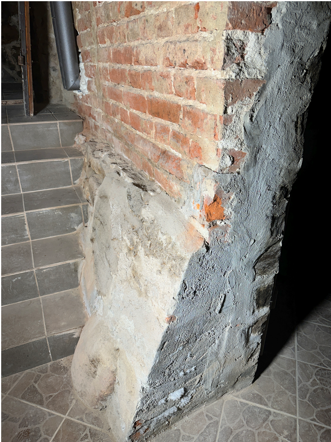
Fot. 7 przykład obrazujący I prawidłowo przeprowadzone naprawy fragmentu ściany przy pomocy zaprawy cementowej – zniszczenie obiektu.
