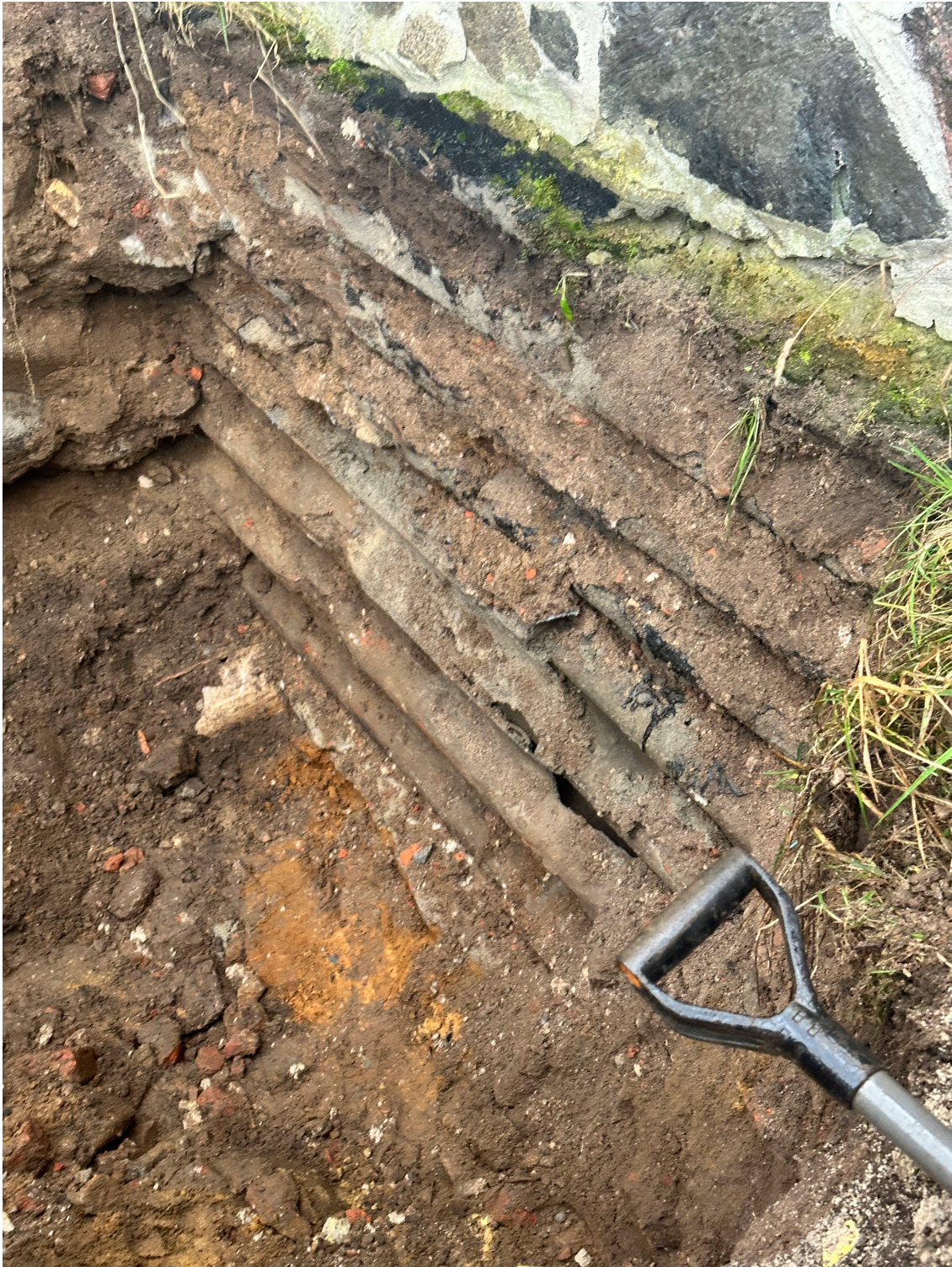
Fot. 17 Fragment fundamentu obiektu z prowizoryczną izolacją pionową.
